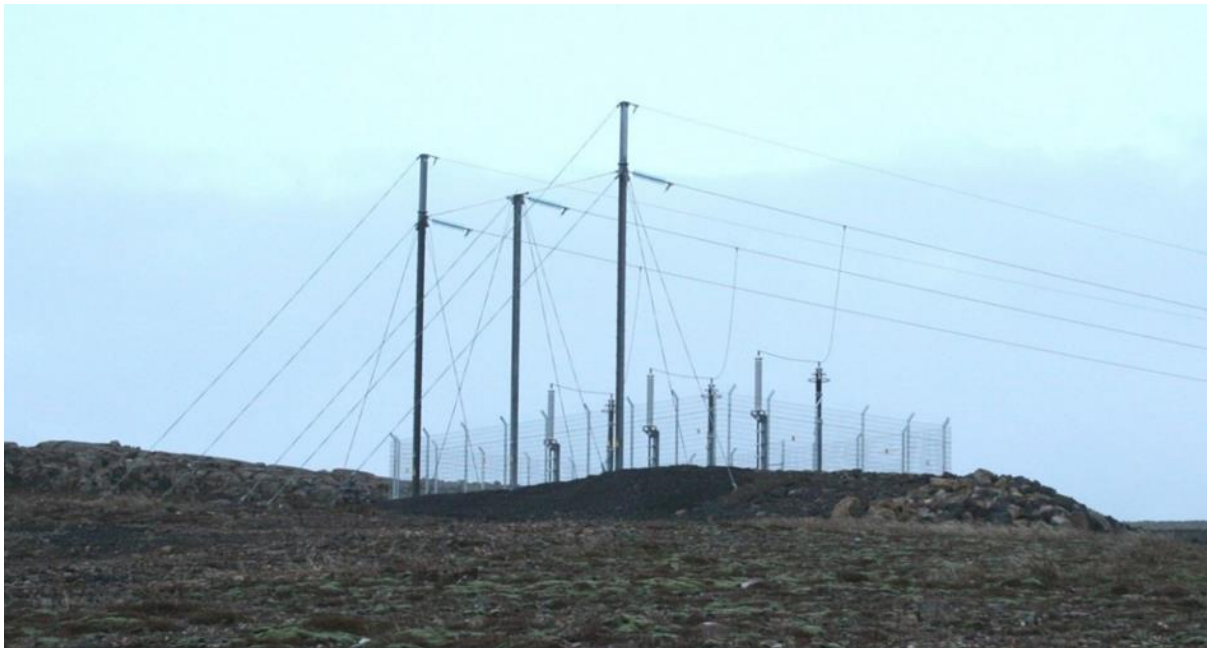
Mynd 6.16. Endavirki fyrir 132 kV jarðstreng (eitt strengjasett) í Hnoðraholtslínu 1. Efst eru jarðvírar til að verjast eldingum.
