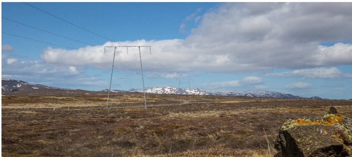
Mynd 6.2 Mastursgerð sem fyrirhugað er að nota á stærstum hluta Holtavörðuheiðarlínu 3. Mynd sýnir mastur án jarðvírseyrna.
