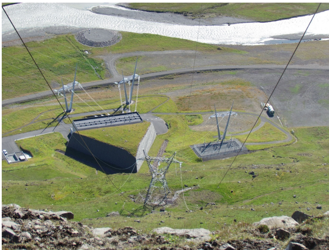
MYND 3.5 Tengivirki í Fljótsdal. Á myndinni sjást Fljótsdalslínur 3 og 4, ásamt Kröflulínu 2, tengjast tengivirkinu. Ljósmynd EFLA.
