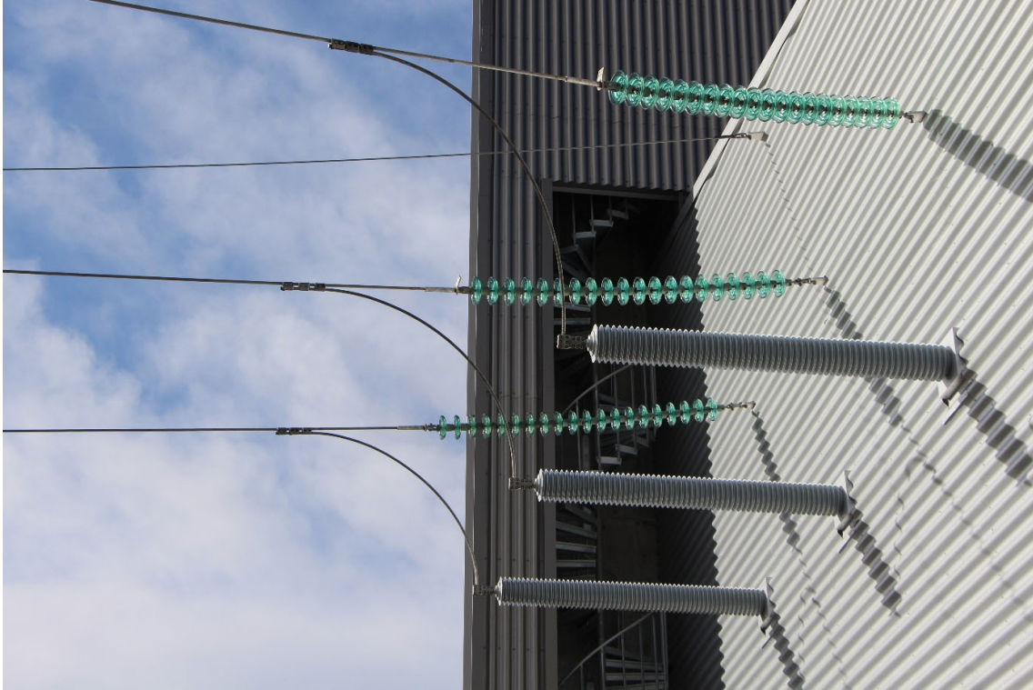
MYND 3.3 Einangrar á leiðara sem tengdur er inn í tengivirki. Ljósmynd EFLA.
